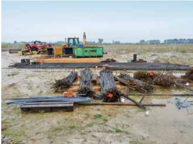
Opuszczony plac budowy w Piaskach Bankowych. Stan na 22 września 2017 roku.
