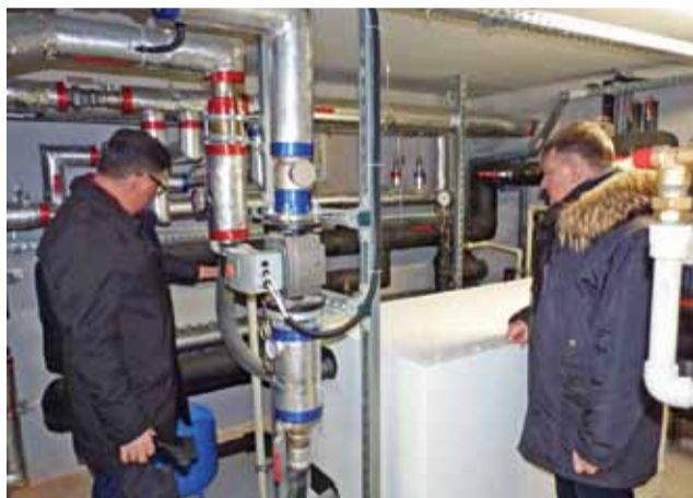
Serce nowego systemu ogrzewania szkoły. Pomieszczenie z pompami ciepła, skąd rozprowadzane jest ono po całym gmachu ZSS. Na zdjęciu Wojciech Brzeski z zarządu powiatu i Maciej Lisowski, dyrektor placówki.
