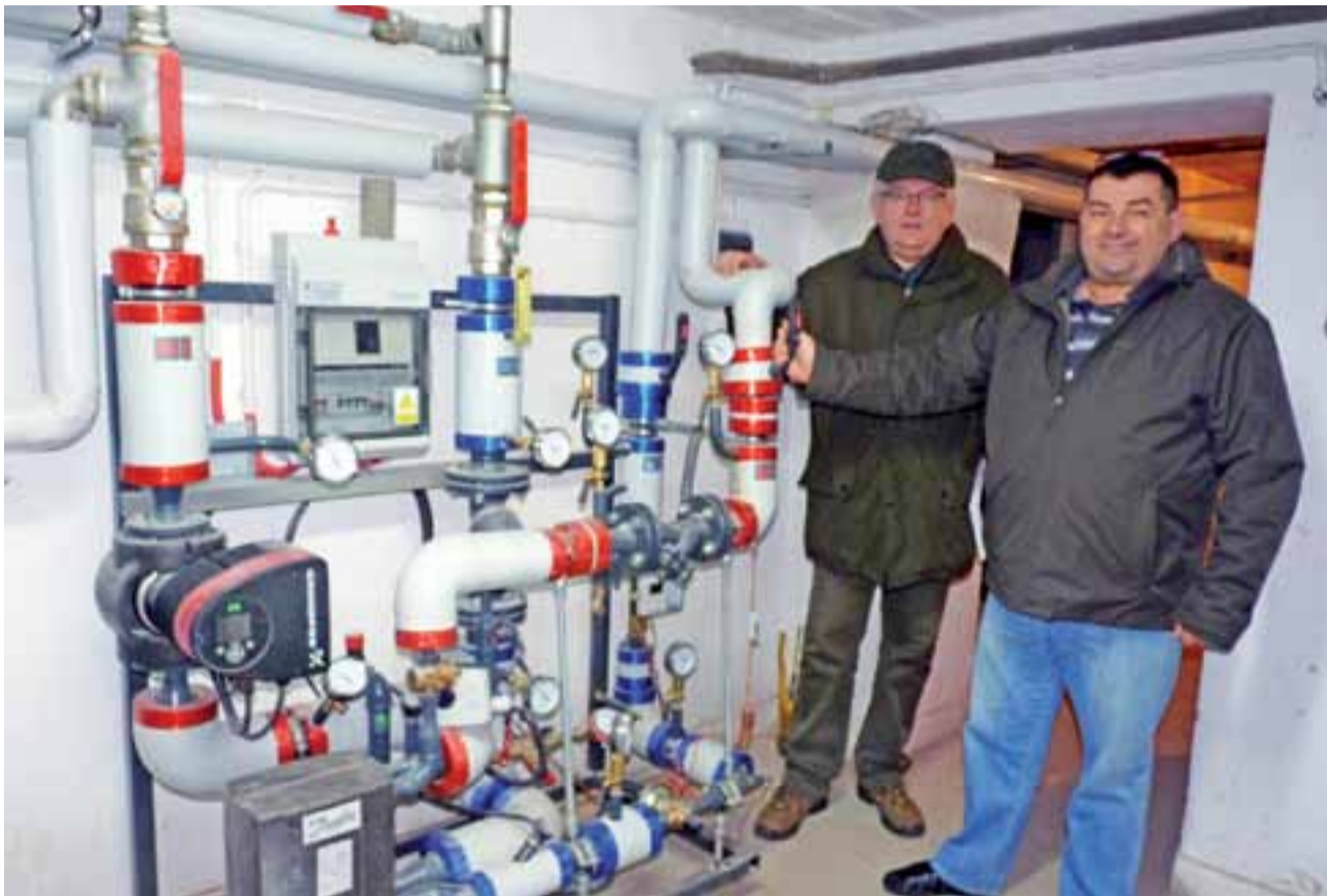
Tak wygląda nowy węzeł co w bloku Narutowicza 79/III. Zdaniem Waldemara Ledziona z firmy Hydrotech oraz Włodzimierza Czajkowskiego nowy węzeł ma pełną automatykę pogodową, jest energooszczędny i bezpieczny.
