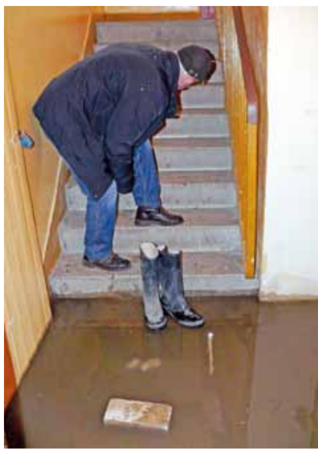
Zalana piwnica w bloku nr 5 na osiedlu Starzyńskiego. Ostatnio wejść do niej można było jedynie w gumowcach i z zatkanym nosem.
