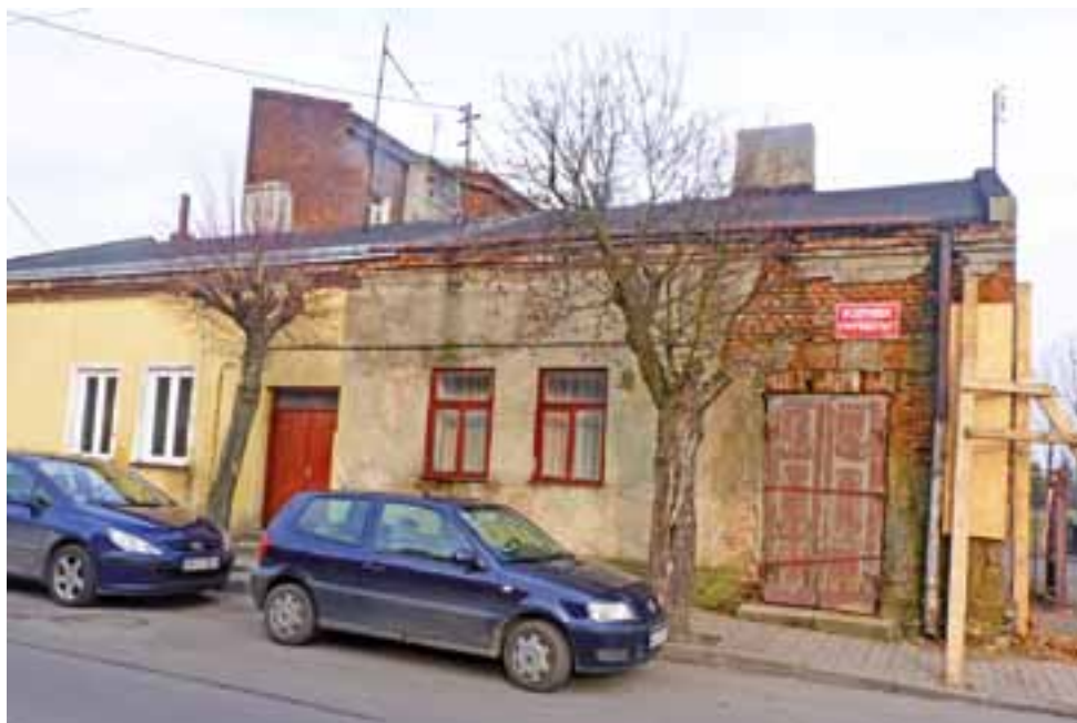
Kamienica przy ulicy Narutowicza 35 w lewej części należy do gminy, w prawej części do osób prywatnych. Wieloletnie zaniedbania ze strony właścicieli doprowadziły do degradacji budynku, który dziś w tej części grozi zawaleniem.
