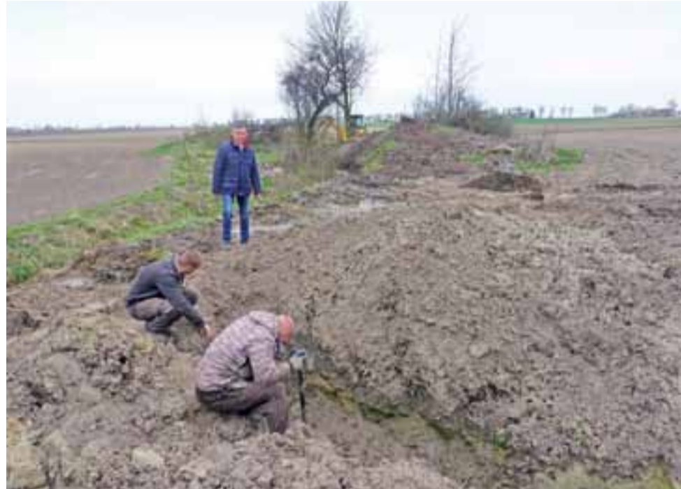
Pracownicy Spółki Wodnej Ziemi Żychlińskiej z wykorzystaniem koparki z Mig-My przez tydzień usuwali dużą i skomplikowaną awarię melioracji w Dobrzelinie.
