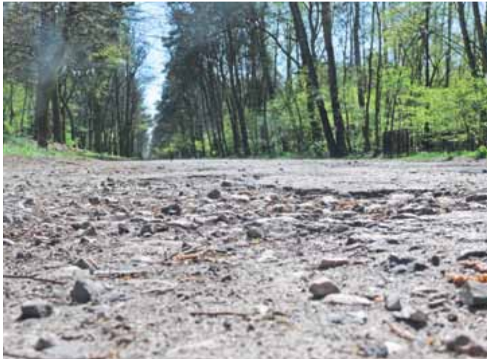
Ulica Łyszkowicka w Lesie Miejskim ma nawierzchnię totalnie zniszczoną, wielu mieszkańcom Łowicza marzy się tam nowy asfalt - niestety, na razie nie ma na to szans.
