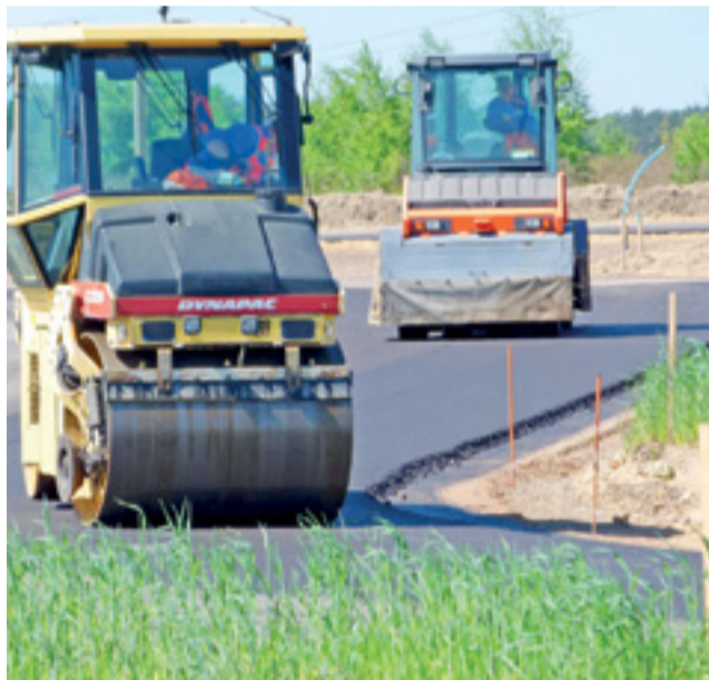
Walcowanie asfaltu na głównym torze. Z tyłu, w tle, miejsce na półowalną płytę do jazdy w warunkach poślizgowych. Na niebiesko oznaczono miejsca, gdzie zainstalowane zostaną zraszacze.
