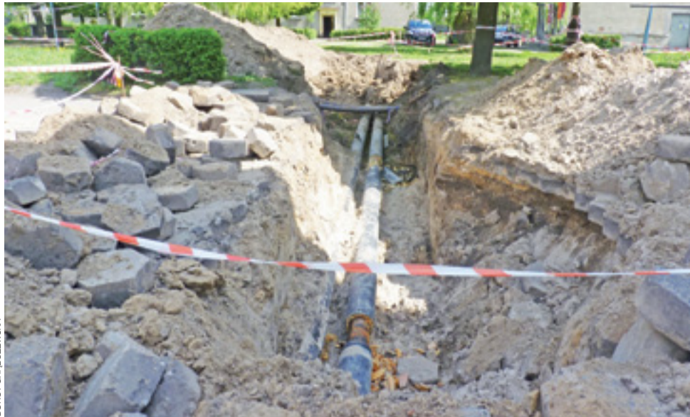
Od 2 tygodni na osiedlu Wyzwolenia w Żychlinie tak wyglądają odkopane rury ciepłociągu, który uległ awarii. Głęboki wykop zabezpieczony jest tylko taśmami.
