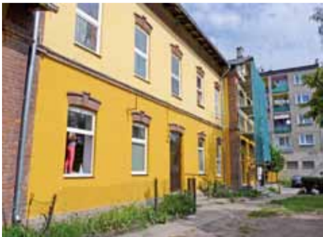
Układanie nowej elewacji od strony podwórka na budynku Narutowicza 73 dobiega końca. Do pomalowania na brązowo zostają fundamenty budynku.
