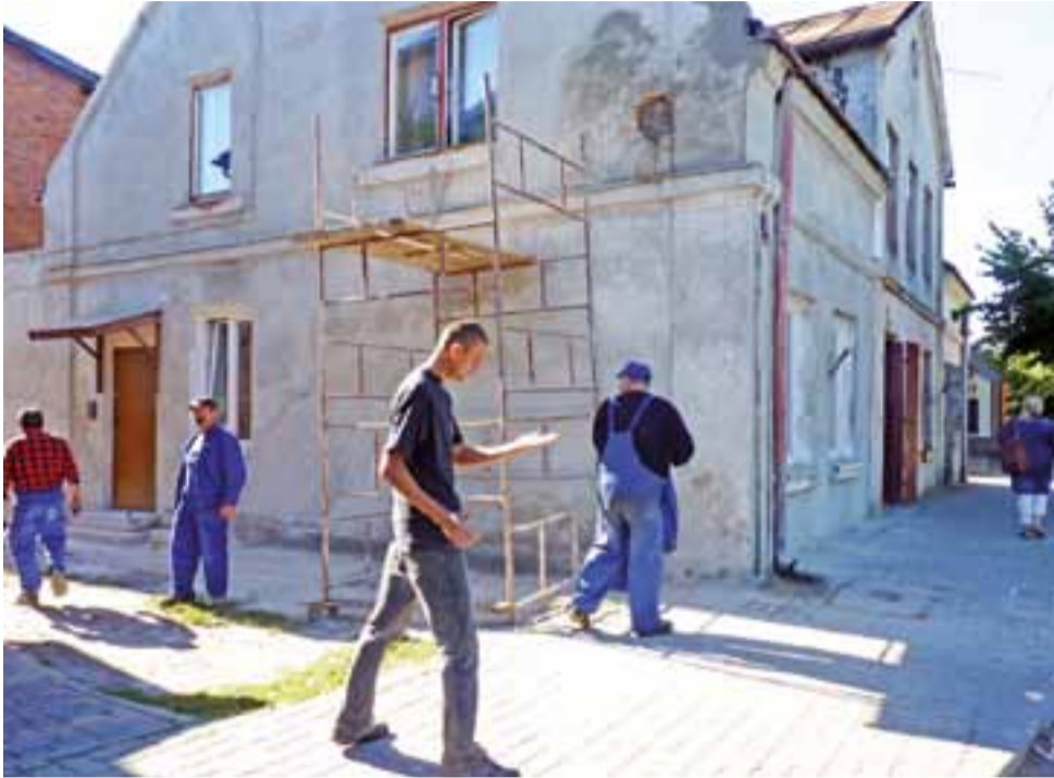
Pracownicy z Samorządowego Zakładu Budżetowego w Żychlinie remontują elewację na budynku Jana Pawła 9 w Żychlinie.
