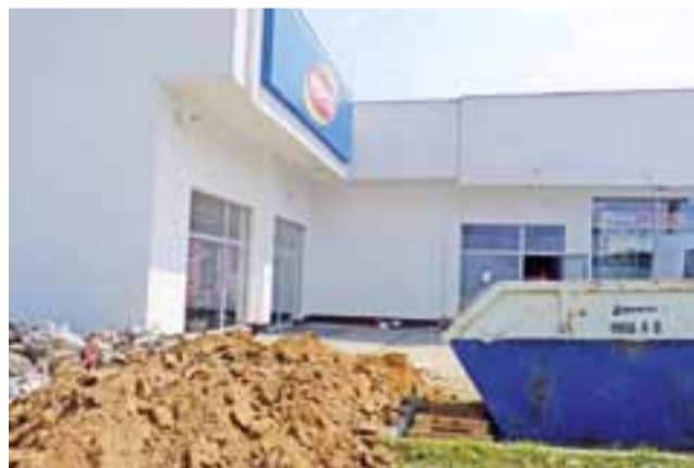
Gruz i piach z jednego z pomieszczeń, o które najprawdopodobniej zostanie powiększony Pepco, jest składowany obok sklepu.
