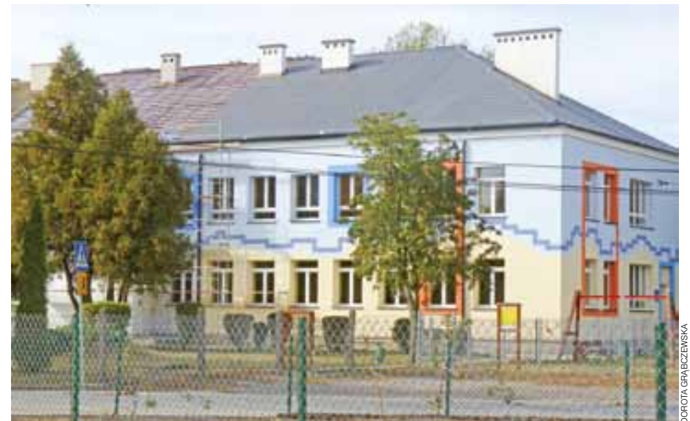
Do końca listopada budynek przedszkola w Skrzyszewach będzie docieplony, z nową elewacją i nowym dachem. Pierwsze efekty widać.
