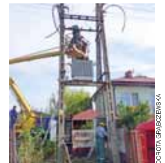
Po modernizacji transformatorów w Pacynie będzie mniej przerw w dostawach energii.
