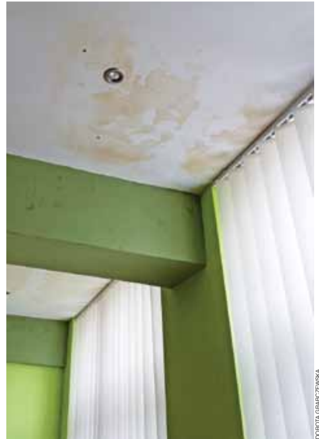
Po ulewie w trakcie remontu zalanych zostało kilka pomieszczeń domu kultury. Na sufitach widać rdzawe wykwity.
