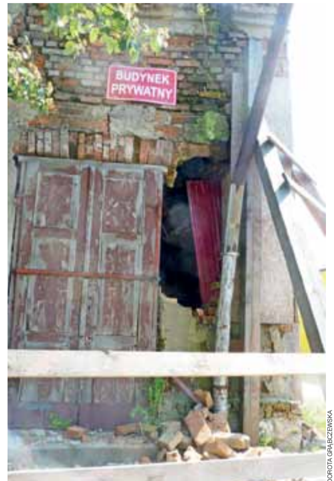
Do 30 kwietnia spadkobiercy kamienicy przy ulicy Narutowicza mieli zabezpieczyć obiekt. Nie zrobili nic. Degradacja postępuje nadal i tylko patrzeć, jak cała ściana się zawali.
