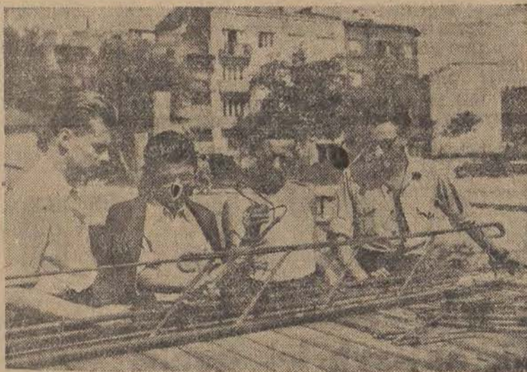
Zaloga SPB-2, budująca obecnie osiedle Ochota w Warszawie, korzystając z doświadczeń robotników radzieckich wprowadza stale usprawnienia w produkcji. Ostatnio na budowie osiedla zastosowano do wiązania zbrojeń belek żelbetonowych odpadki żelaza zamiast powszechnie używanego kosztownego sześciomilimetrowego drutu. Elementy zbrojeń łączy się krótkimi kawałkami żelaza za pomocą spawania. Praca postępuje szybciej, lepiej i taniej niż przy wiązaniu drutem. Na zdjęciu: robotnicy z SPB-2 pokazują nowe wiązanie przedstawicielom prasy.
