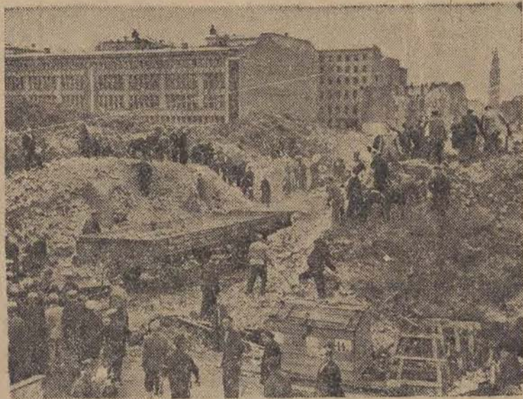
Dnia 1 września br. przystąpiono w Warszawie do pracy na terenach przeznaczonych dla Trasy N-S. Na zdjęciu: pierwsze ochotnicze brygady złożone z pracowników stołecznych zakładów pracy.
