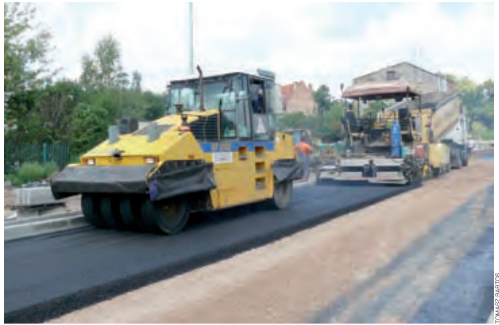
Rozścielacz masy bitumicznej na ul. Dmowskiego oraz jeden z pracujących na niej walców w czasie układania pierwszej warstwy asfaltu.
