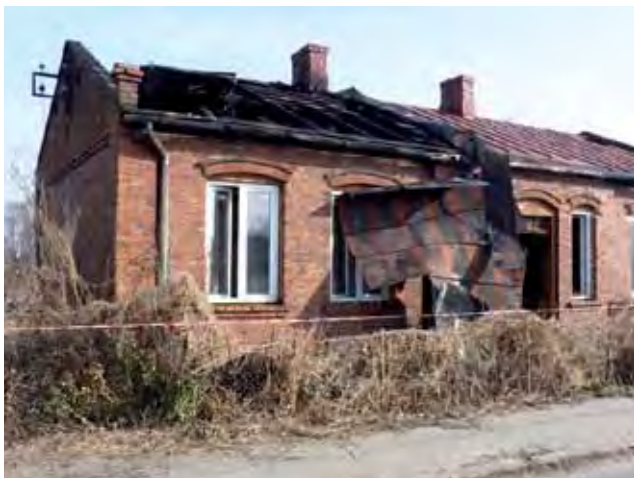
Jednego wieczora paliło się w Dąbkowicach Górnych w dwóch miejscach. Jednym z nich był pustostan, który opustoszał po tym, jak kilka dni wcześniej zmarł jego właściciel.
