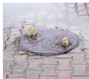
Woda wybijała ze studzienek to na osiedlu Korabka spory problem podczas większych opadów.
