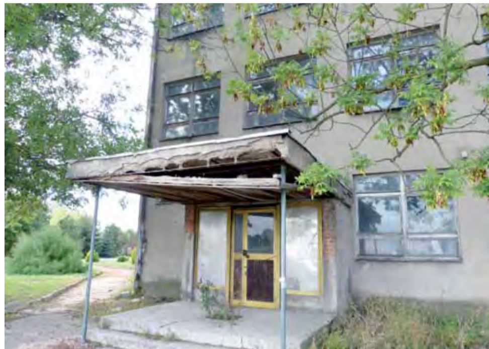
Daszek nad wejściem do dawnego biurowca rozwarstwił się i w każdej chwili może runąć.
