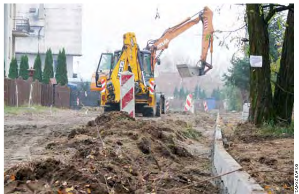
Budowa nawierzchni ul. Moniuszki na os. Górki rozpoczęła się od ułożenia krawężnika.
