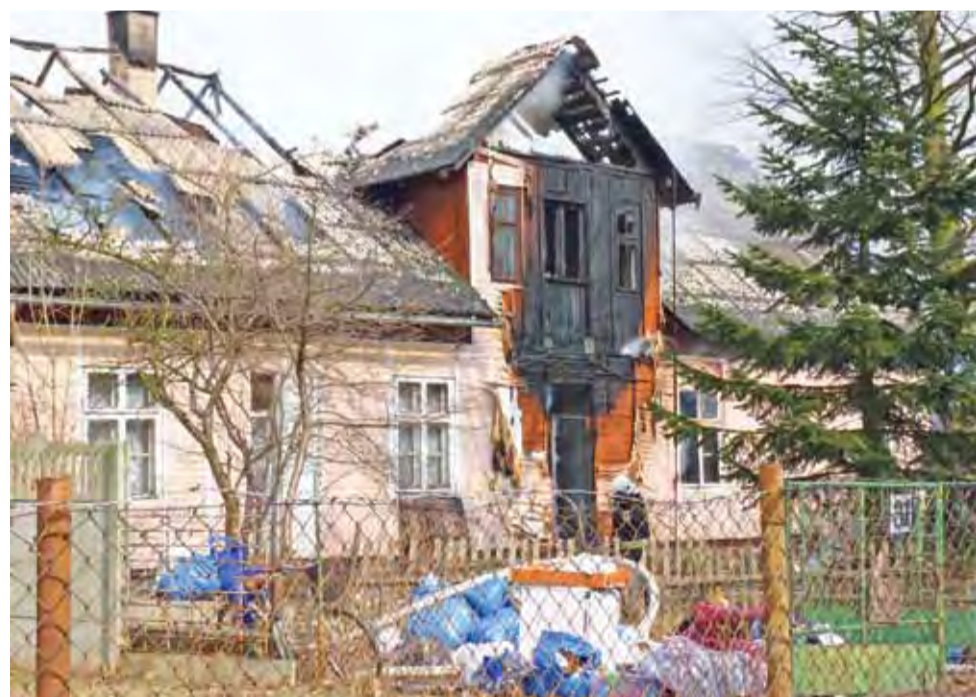
Pożar na ul. Zabrzeźniańskiej. Z drewnianego domu, przeznaczonego na wynajem, pozostało niewiele. Lokatorzy zostali bez dachu nad głową.
