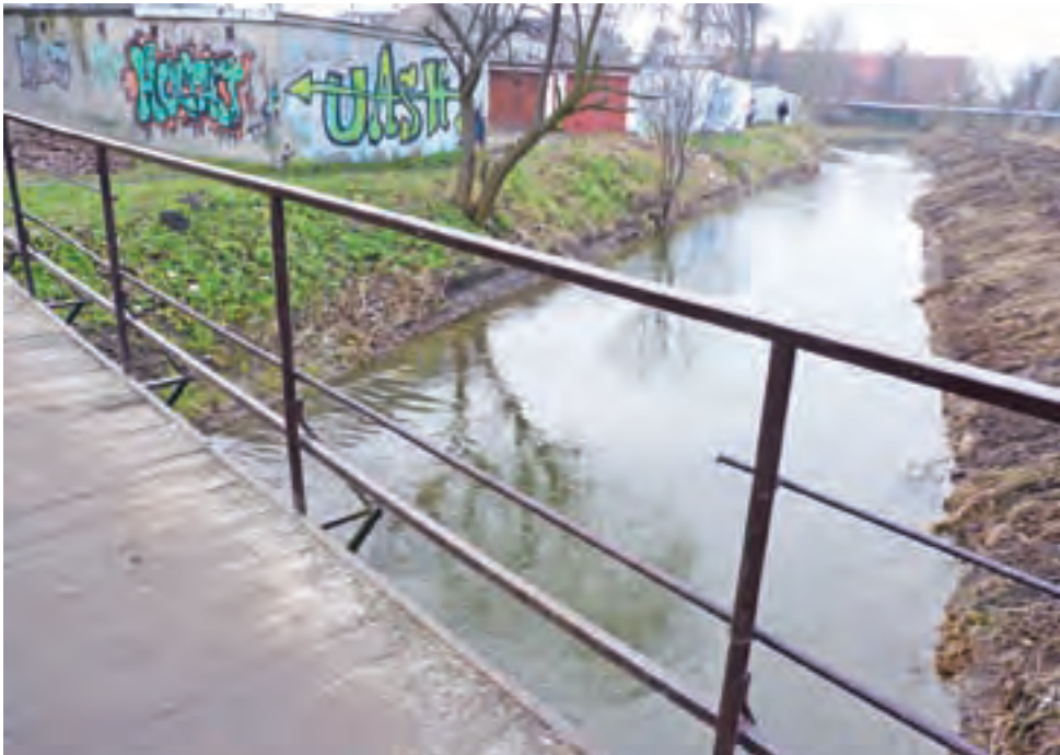
Wandale wyłamali pręty w barierze zabezpieczającej kładkę nad rzeką.
