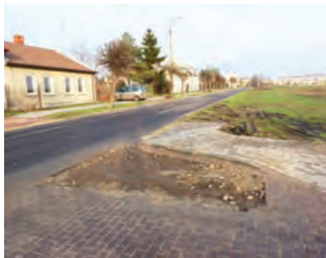
Awaria wodociągu w nowo wyremontowanej ulicy Dobrzelińskiej na szczęście miała miejsce na końcówce ulicy, gdzie była kostka polbrukowa, a nie nawierzchnia asfaltowa.
