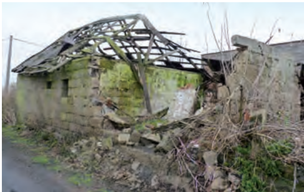
Sołtys Zleszyna poruszył problem walącego się budynku w Zleszynie, który stanowi zagrożenie.
