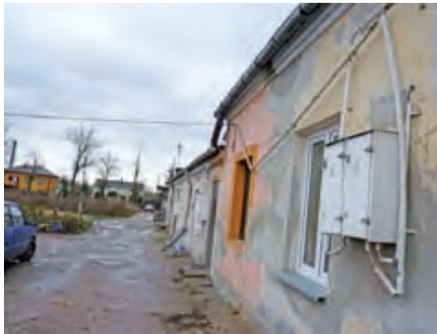
Mieszkańcy budynku komunalnego czekają na dokończenie remontu elewacji, założenie daszków, utwardzenia drogi i poprawy wiszącej w beładzie instalacji elektrycznej.
