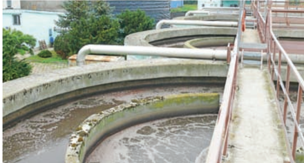
Komory nityfikacji, czyli napowietrzania, z pomalowanymi barierami oraz widocznymi nowymi rurami doprowadzającymi powietrze do dysz zanurzonych w oczyszczanych ściekach.
