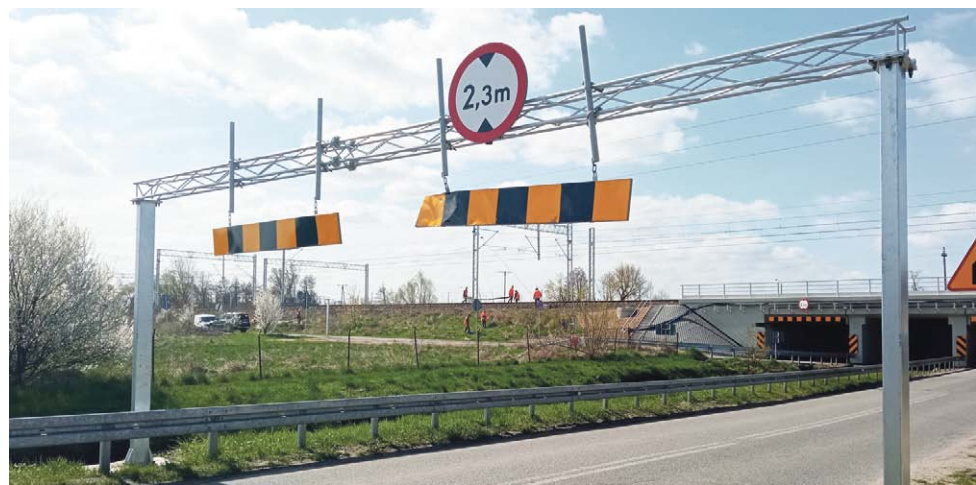
Niedawno ustawiona bramownica drogowa została już mocno poturbowana przez nieuwważnych kierowców. Trudno to zrozumieć, kiedy tuż nad nią znajduje się znak informujący o maksymalnej wysokości pojazdów, widoczny już z dalszej odległości.
