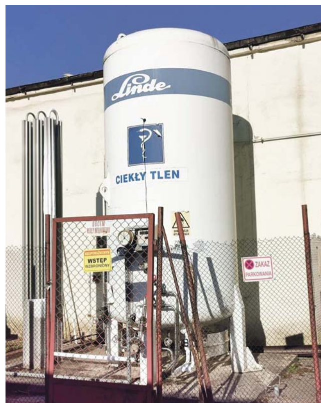
Instalacja tlenowa szpitala w Łowiczu zasilana jest z zewnętrznej butli na ciekły tlen, znajdującej się na terenie szpitala.
