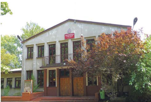
Budynek po liceum w Zdunach z roku na rok niszczeje. Tak wyglądał jeszcze 4 lata temu.
