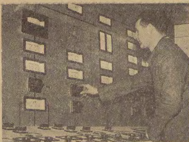
Praca palacza koncentruje się przy tym pulpicie. Wystarczy przekręcić gałkę, aby wyregulować dopływ powietrza i wody do kotła.
