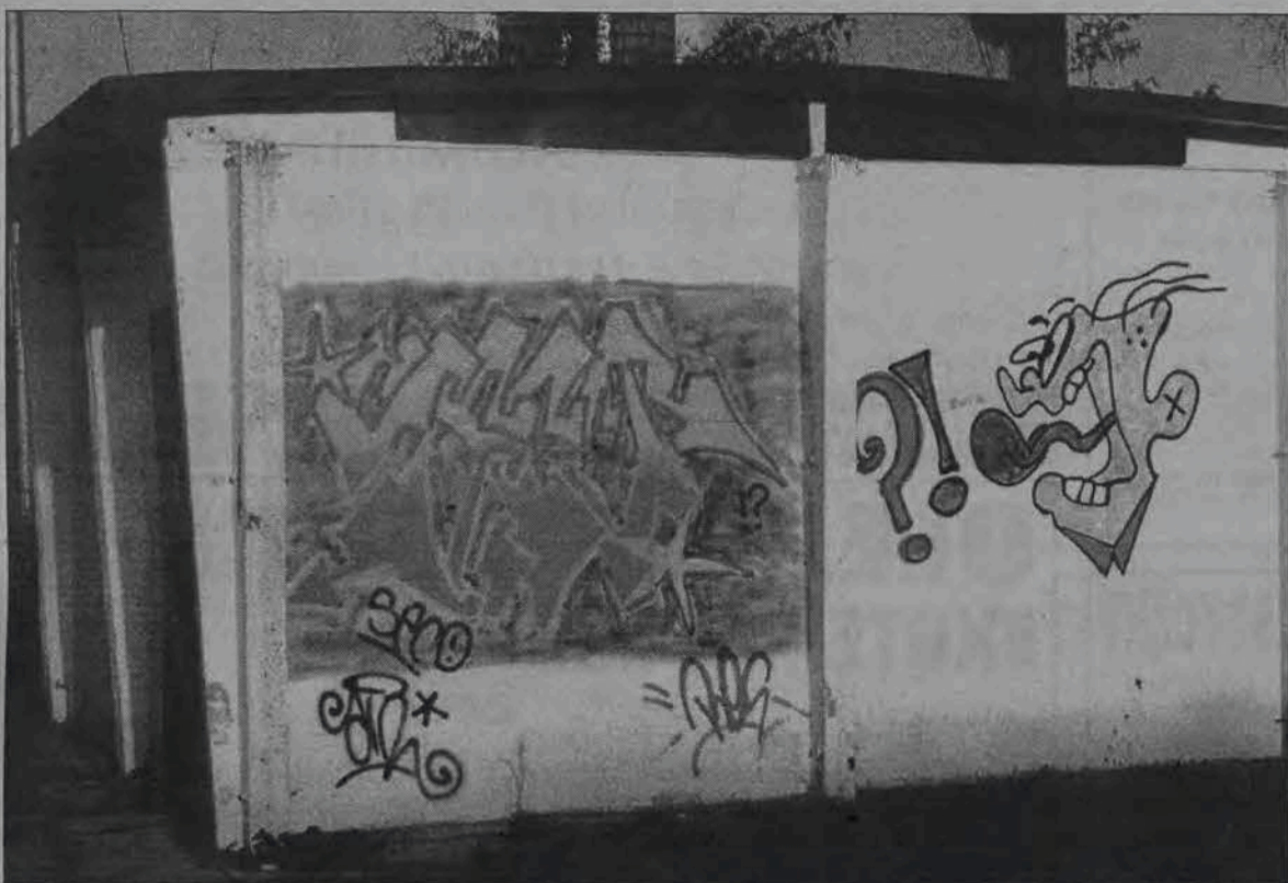
Tak prezentuje się już od dłuższego czasu jedna ze ścian stacji transformatorowej przed blokiem numer 4 na osiedlu Bratkowice w Łowiczu. Grafitti pojawiło się kilka dni po odnowieniu budynku stacji.
