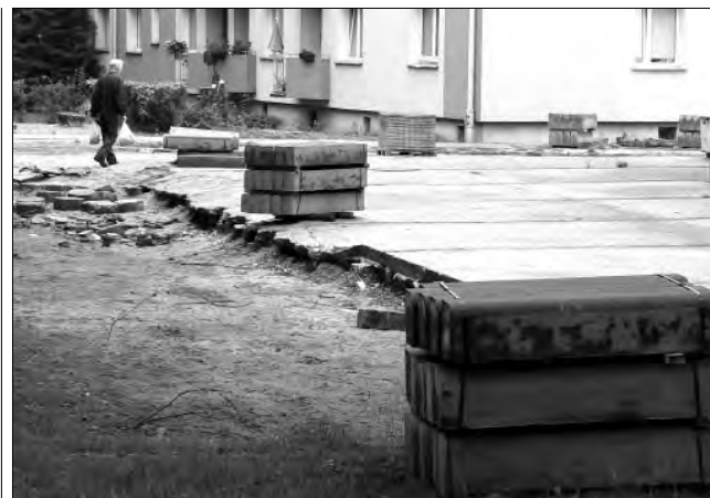
CHODNIKI NA OSIEDLU REYMONTA w Łowiczu kończy układanie brygada remontowo-budowlana ŁSM. Aktualnie trwają prace przed blokiem nr 3, a potem mają być dokończone chodniki pomiędzy blokami 2 i 3. W dalszej kolejności uporządkowany będzie plac, na którym kiedyś magazynowany był węgiel dla osiedlowej kotłowni. Teraz ma tam zostać zorganizowany parking dla mieszkańców. (mak)
