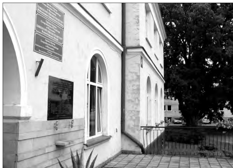
Z części frontowej ściany szkoły Blichowskiej zaczął sypać się tynk i odpadać farba, szkoła chce jesienią dokonać jej remontu.
