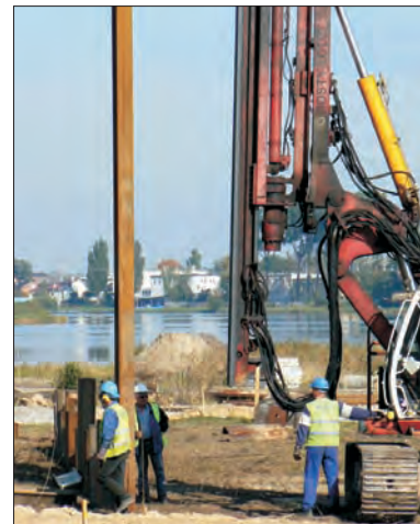
Charakterystyczne dźwięki wbijania metalu, to efekt pracy kafara. W ten sposób powstaje ścianka szczelna - pierwszy etap budowy mostu.
