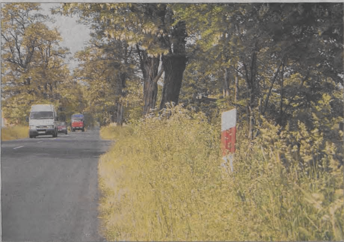
Obecnie pobocza na drodze do Łęczycy są tak zarośnięte, że widać jedynie fragmenty przydrożnych słupków.
