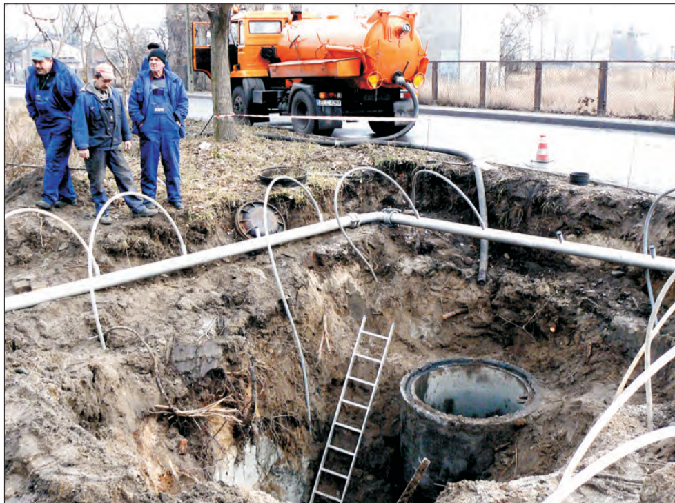
ŚCIEKI Z CZAJEK POPLYNĄ SZYBCIEJ. Brygada wodociągowo - kanalizacyjna ZUK w Łowiczu usunęła w miniony czwartek poważną awarię przy ulicy Kaliskiej powstałą na kolektorze kanalizacji sanitarnej odprowadzającym nieczystości z osiedla Czajki. Konieczne było wykonanie odwodnienia igłofiltrami i ponad 4-metrowy wykop. Wymieniono przełamana rurę kamionkową, tuż przy studziencie kanalizacyjnej znajdującej się w poboczu ulicy. Pęknięcie powodowało utrudnienia w przepływie nieczystości.
