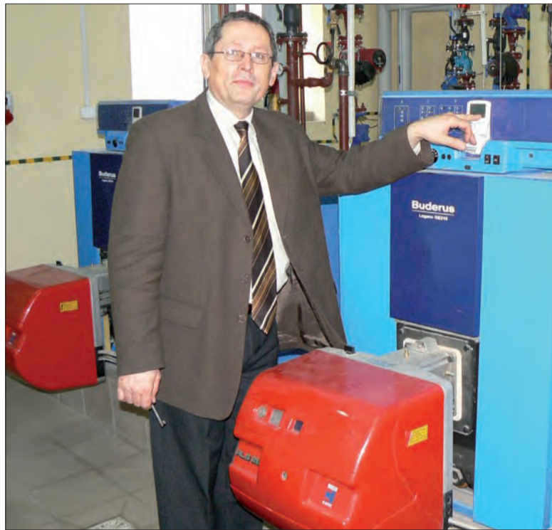
Dyrektor Wacław Witwicki szczególnie cieszy się z nowego wyposażenia kotłowni. Ciekące piece węglowe spędzały mu sen z powiek.
