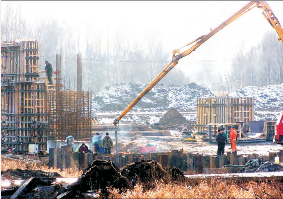
ROŚNIE WIADUKT NAD MOSZCZENICĄ. Robotnicy budujący obwodnicę autostradową Strykowa wylewają już podpory pod wiadukt. Prace idą zgodnie z harmonogramem. Jeśli zima będzie nadal łagodna, za miesiąc przeprowadzą nad rzeką Moszczenicą i drogą Stryków - Cesarka pierwszą południową nitkę autostrady A-2 na jej nowym odcinku.
