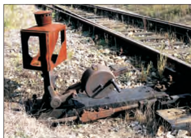
Stan rozjazdów na tym odcinku jest fatalny.
