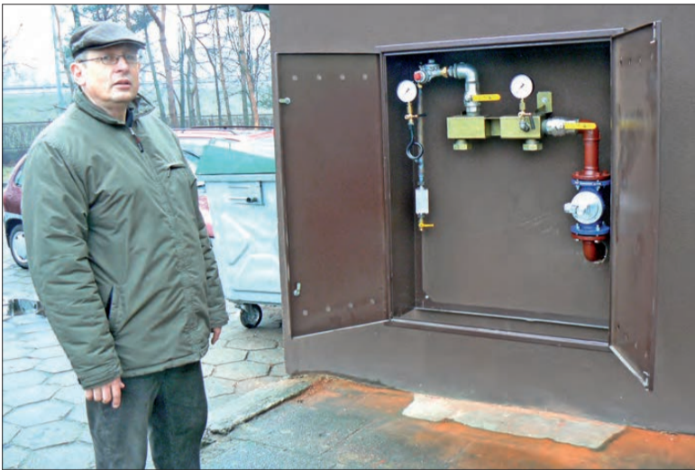
Dyrektor Zespołu Szkół Wacław Witwicki obok skrzynki, do której będzie doprowadzony gaz.
