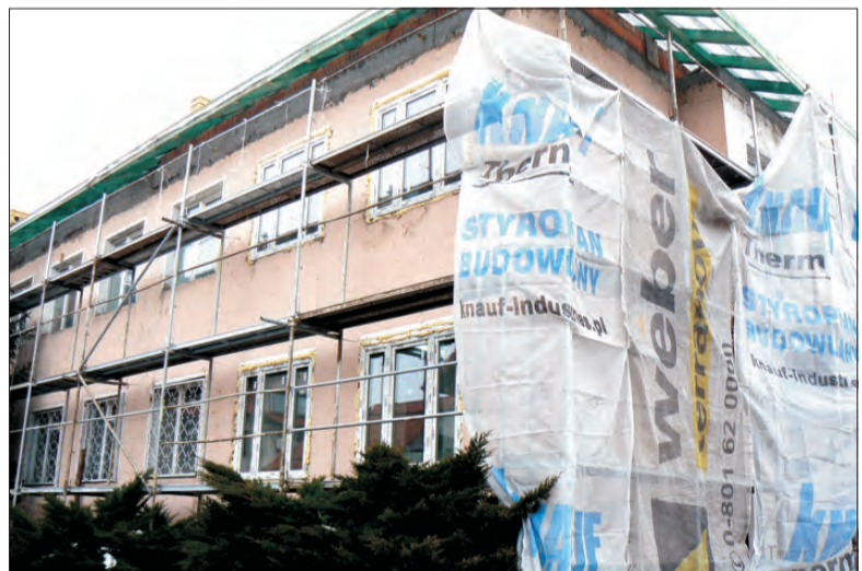
Nowy dach, okna, elewacja - stary budynek zmienia oblicze w ciągu kolejnych tygodni.
