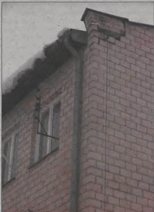
Na szczęście pęknięty narożnik pochylił się w kierunku dachu, a nie na zewnątrz.
