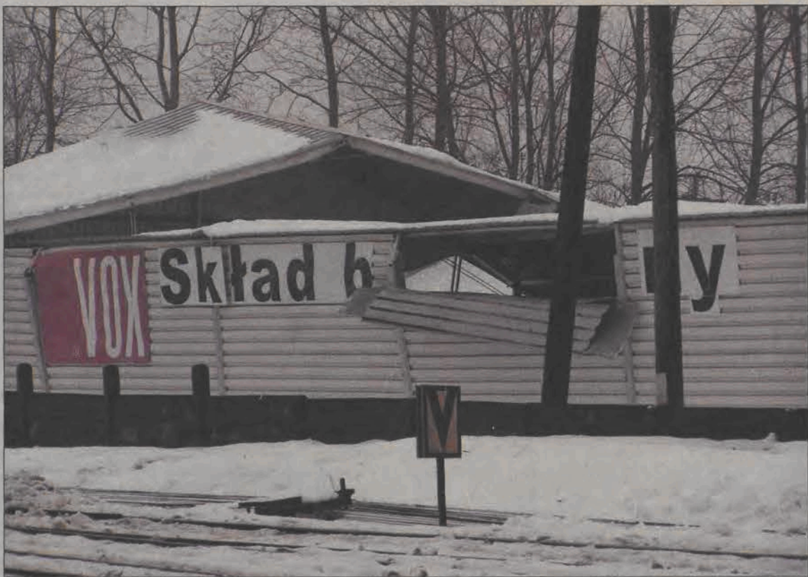
Zniszczona przez obfite opady śniegu hala magazynowa Składow Budowlanych VOX ma być odbudowywana na wiosnę. Powstanie tu budynek o cięższej konstrukcji.
