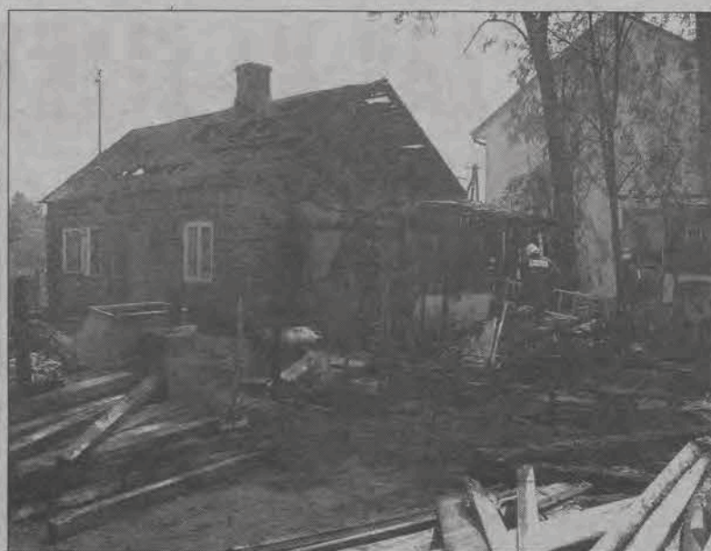
Spaliła się stodoła oraz dach przylegającego do niej domu.
