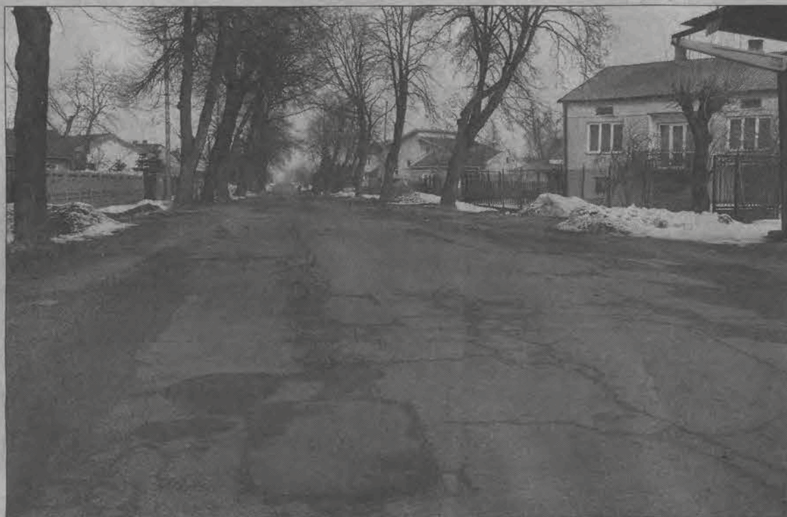
To są potrzeby prawdziwe: ulica Kiernozka należy do najbardziej zniszczonych spośród tranzytowych ulic w mieście i dobrze, że na jej przebudowę będą pieniądze.
