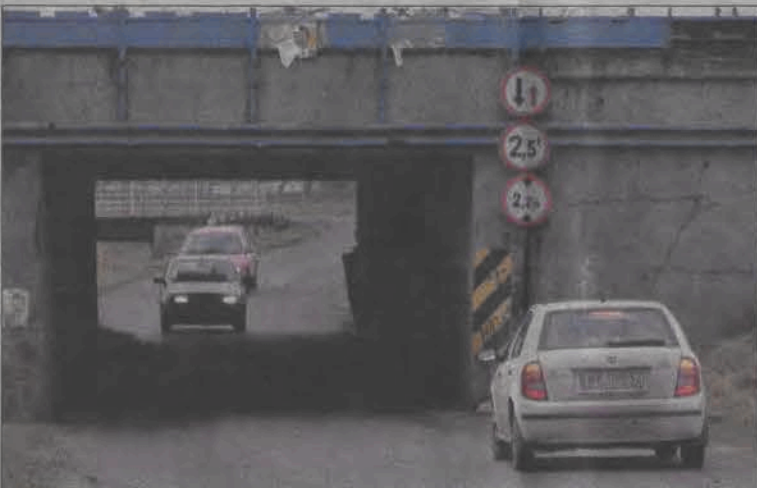
Zła widoczność z jednej jak i z drugiej strony tego wiaduktu przy ul. Arkadyjskiej powoduje, że nie jest to bezpieczne miejsce.
