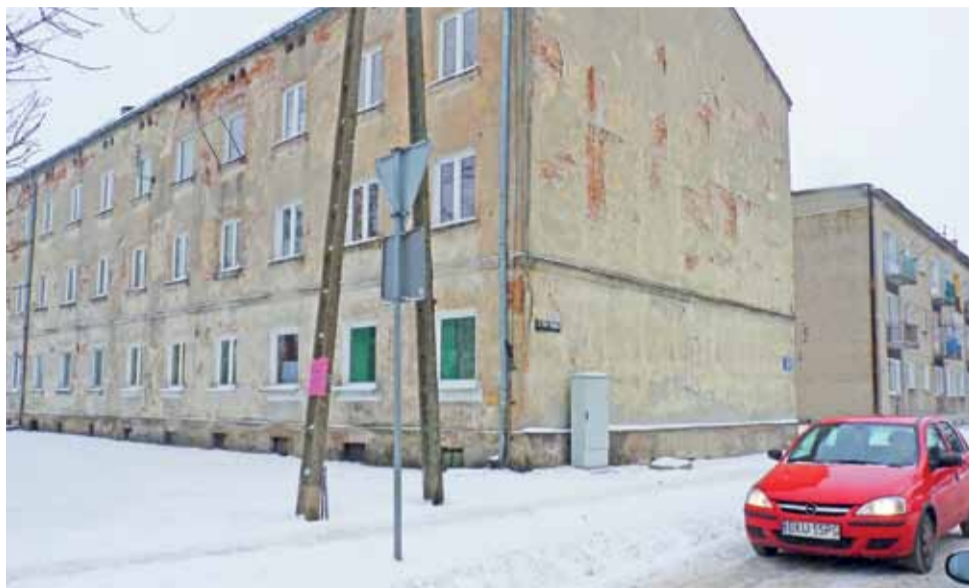
W 2014 roku zostanie zrobiona elewacja na całym bloku przy ulicy Narutowicza 79. Teraz tynk w wielu miejscach odpadł.
