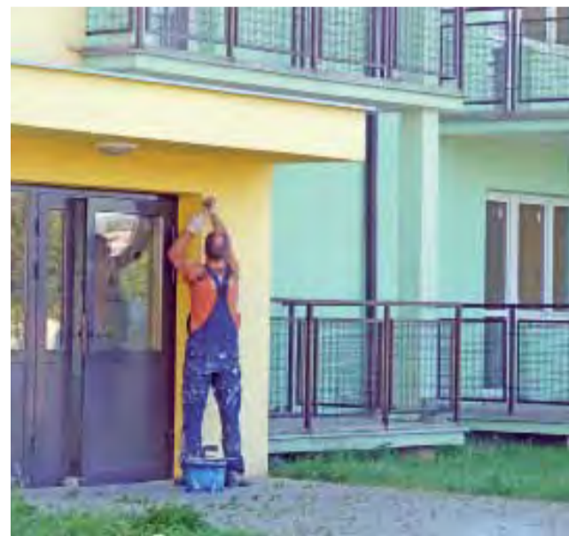
Firma, która budowała blok TBS w Zychlinie, który już jest własnością gminy Zychlin, w ramach gwarancji dokonywała drobnych poprawek.
