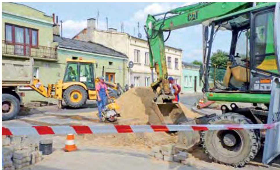
W piątek po godz. 13.00 wyłączono z ruchu część ulicy 1 Maja, na wysokości ulicy Kilińskiego. Przyczyną utrudnień była awaria ciepłociągu.
