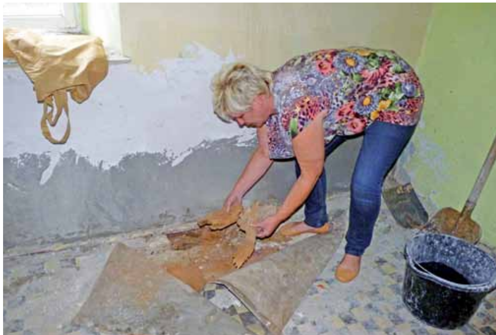
Tydzień temu w lokalu , do którego mają być eksmitowani, tak wyglądało. W drugim pokoju podłoga była tak spróchniała, że kobieta rwała ją rękoma.
