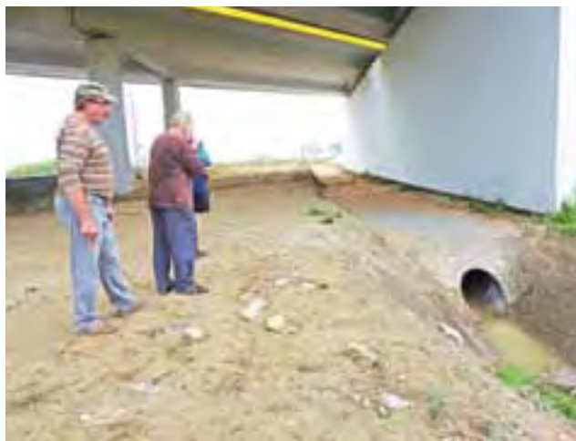
Niecały miesiąc temu otwarty rów pod wiaduktem A1 został przykryty. Ułożono rurę o średnicy 80 cm, ale gołym okiem widać, że nie ma zachowanych odpowiednich spadków, gdyż woda u wejścia do rury stoi nawet po małym deszczu.
