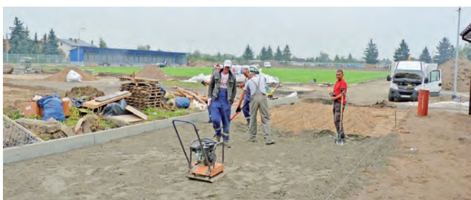
30 września po południu prace na stadionie miejskim szły pełną parą, a powinny być zakończone.
