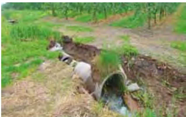
Zerwany mostek. Po nawałnicy państwo Długoleccy nie mają jak wjechać do swojego sadu, by wykonać opryski. Stan na 7 czerwca.
