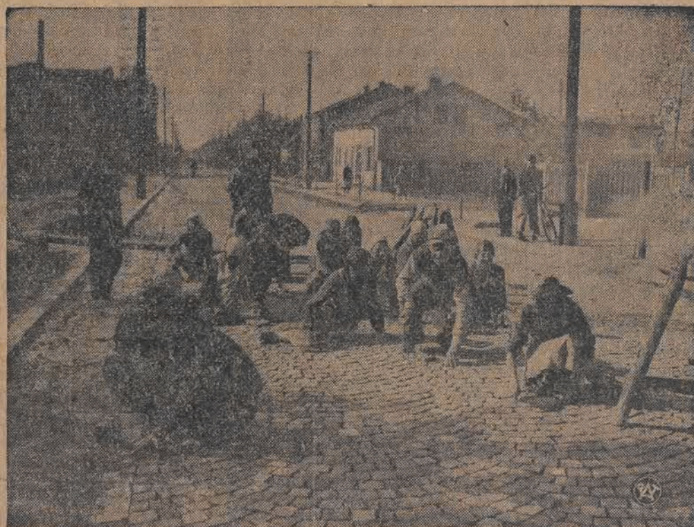
Budowa nawierzchni z kostki granitowej szosy budowanej w Kszeszowicach z zasiłku Funduszu Pracy.
