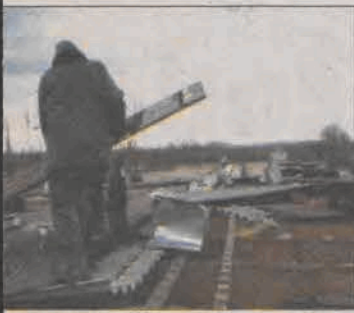
W Łyszkowicki Hotel Berlin stracił dach. W piątek zaczęto naprawę.
