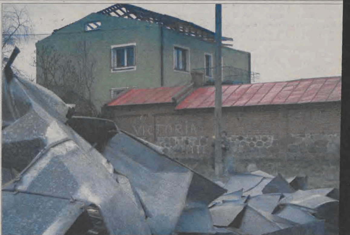
Tyle zostało z dachu widocznego w tle domu w Kompinie po nocnym huraganie z czwartku na piątek. Podobne zdarzenia miały miejsce na terenie całego powiatu.
