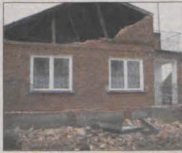
W Gągolinie wiatr wyrwał część ściany budynku mieszkalnego.
