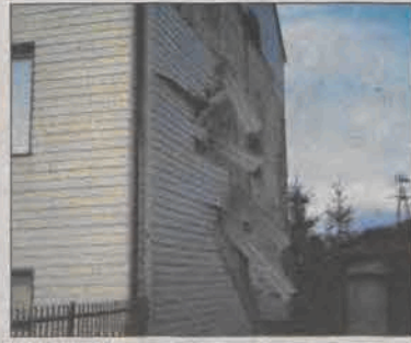
Zniszczone docieplenie domu przy ulicy Rzemieśniczej w Łowiczu.
