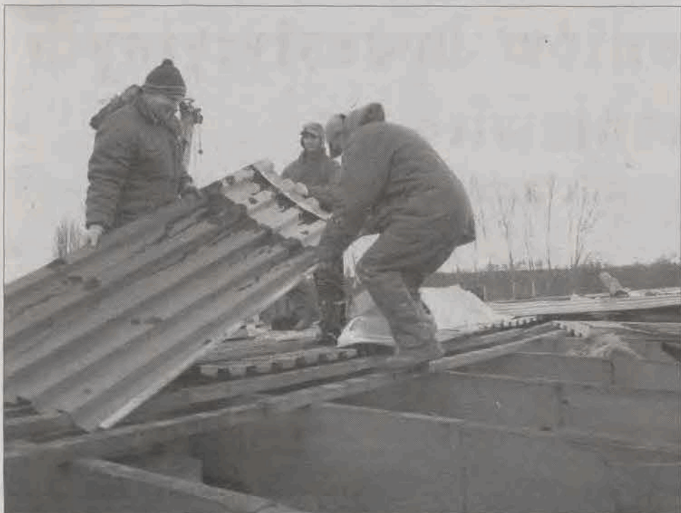
Tak wyglądał dach na hotelu Berlin po wichurze. Zabezpieczyli go pracownicy łowickiej firmy Budowa.
