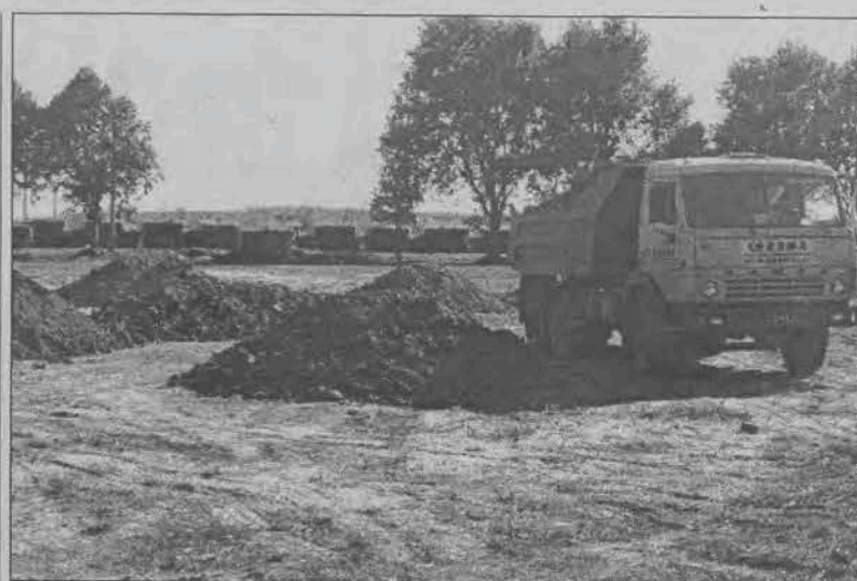
Ziemia z drogi na parking. Co jakiś czas teren prowizorycznego parkingu przy tamie na zalewie Mrożyczka jest wyrównywany. Przed harską imprezą zasypano piaskiem dziurę w centralnym punkcie placu. W minionym tygodniu natomiast nawieziono kilka wywrotek ziemi pochodzącej z wykopów wykonywanych przy okazji modernizacji trasy 14. (ljs)
