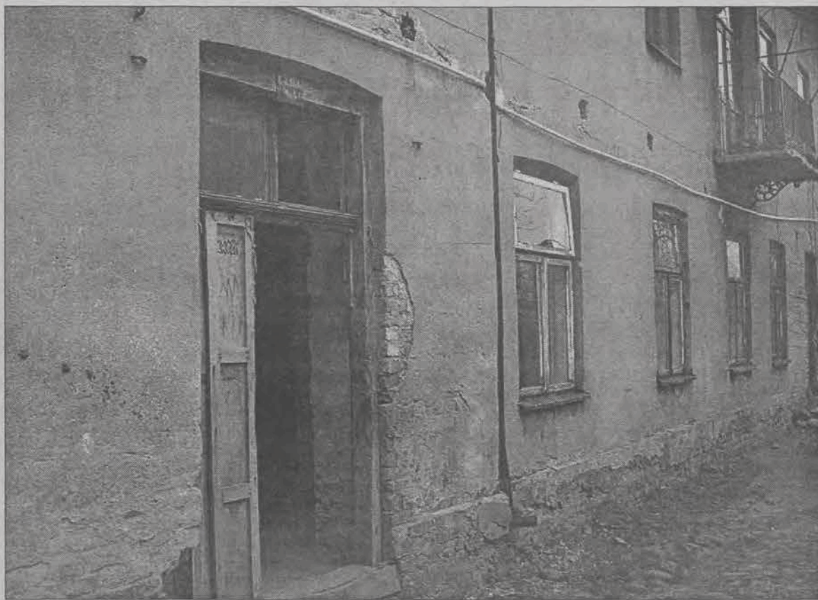
Na remont takich budynków po prostu nie ma pieniędzy.
