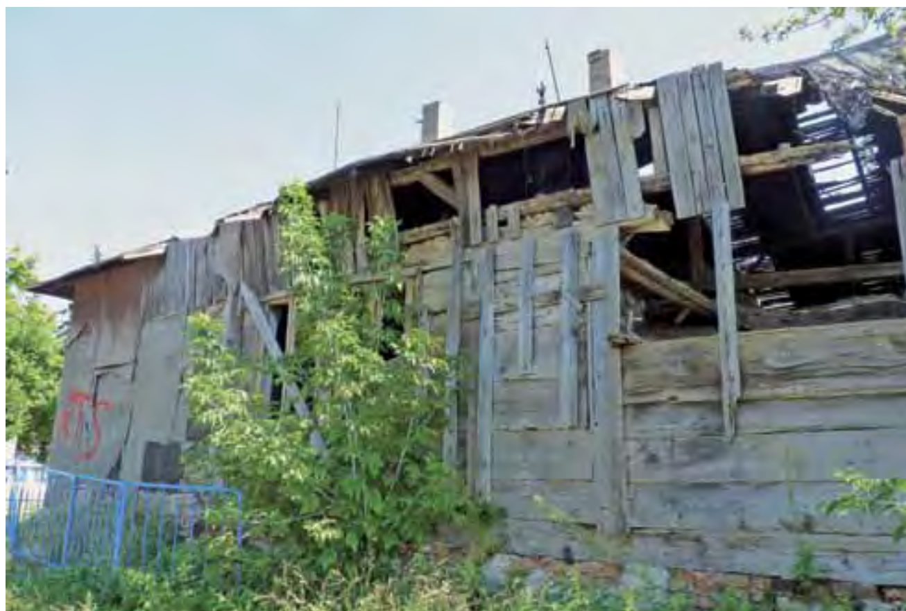
Rudera wygląda źle z ulicy, a od tyłu jeszcze gorzej. Brak części ściany odstania podziurawiony dach.
