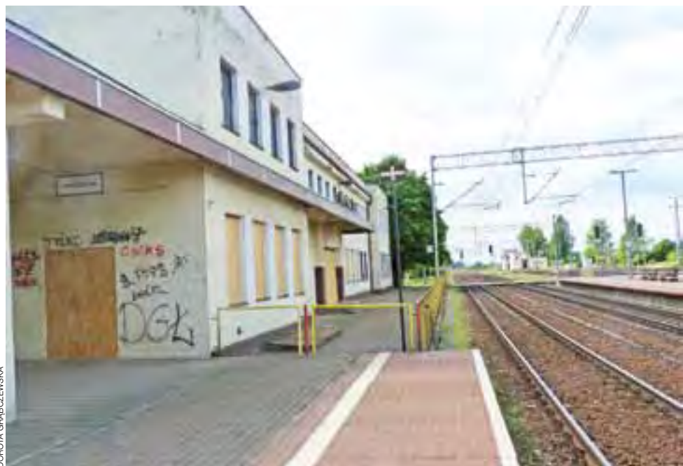
PKP S.A. zdecydowało, że budynek dworca w Żychlinie zostanie rozebrany ze względu na zły stan techniczny i zbyt bliską odległość od torów.
