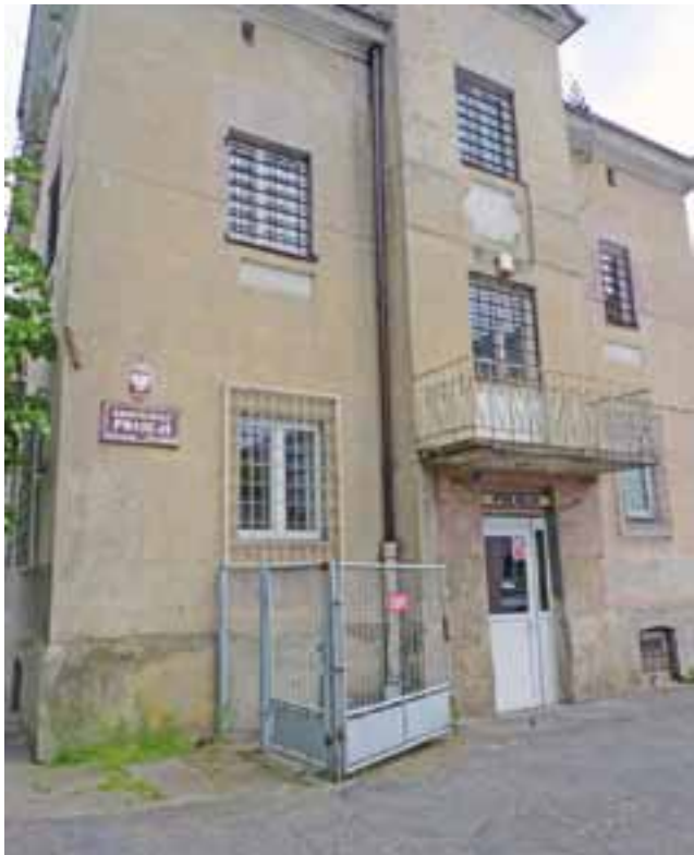
Gmina Żychlin dokłada 25 tys. zł do remontu elewacji komisariatu w Żychlinie, który teraz wygląda szkaradnie.
