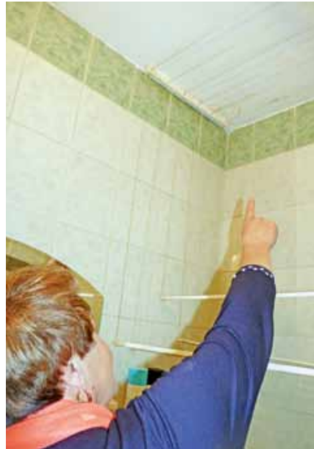
Po remoncie w grudniu 2014 roku łazienka pani Bogusławy znów została zalana. Na suficie farba odeszła, a tynk za płytkami spuchł i tylko patrzeć, kiedy zaczną one odlatywać.
