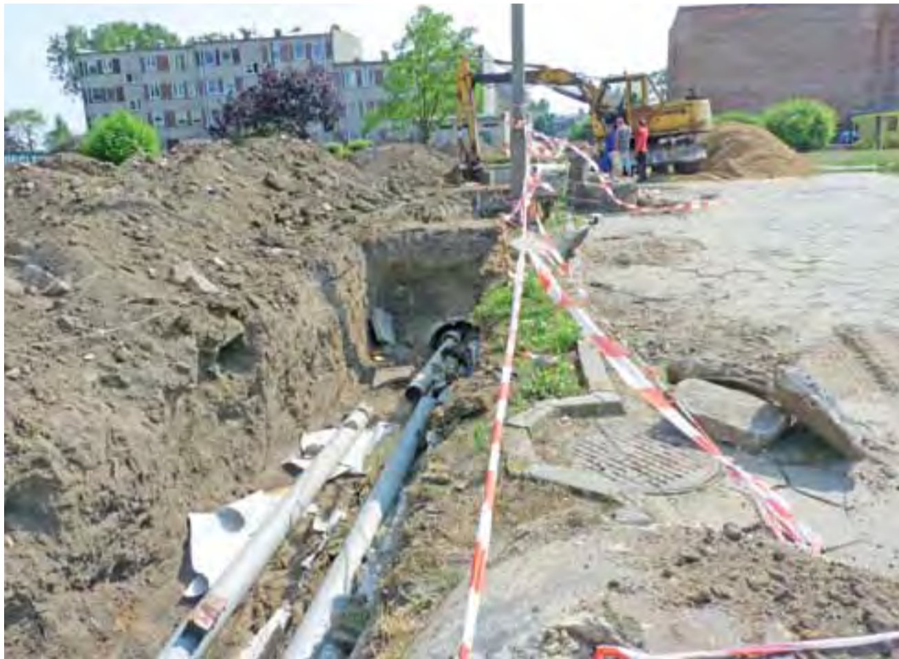
Głębokie wykopki zabezpieczono biało-czerwonymi taśmami, które wciąż są zrywane przez ludzi.
