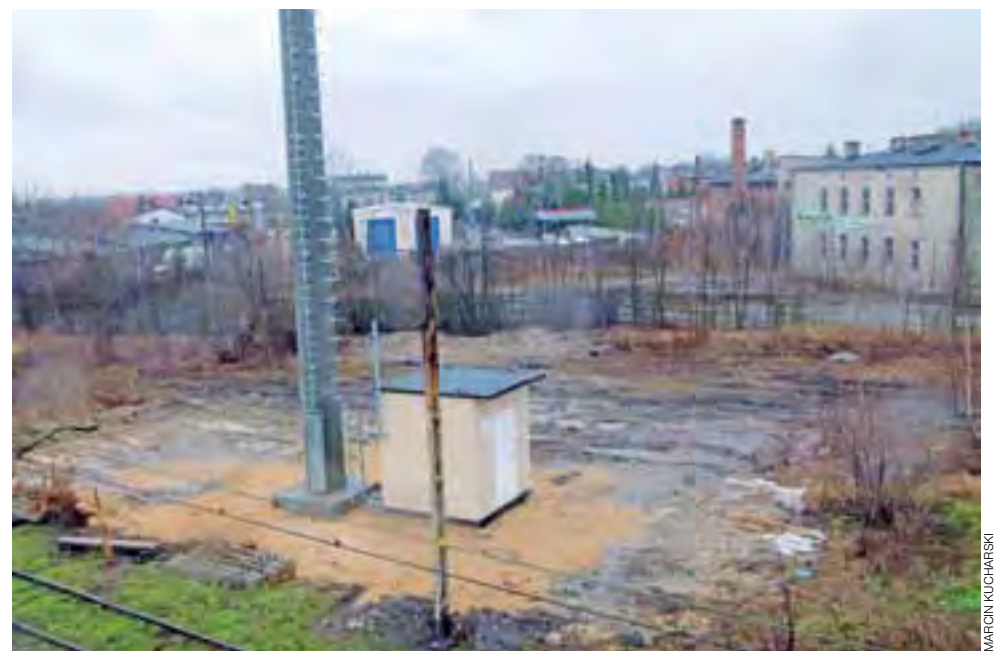
Maszt przy dworcu widziany z kładki nad torami. Wkrótce będą zakładane nadajniki GSM.
